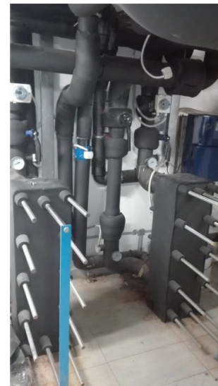
Slika lijevo: međuzmjenjivač Slika gore: pumpe podzemne vode
