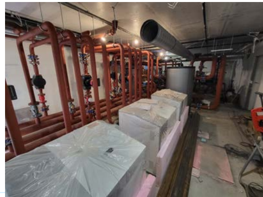
DT tlo-voda 3x100 kW
